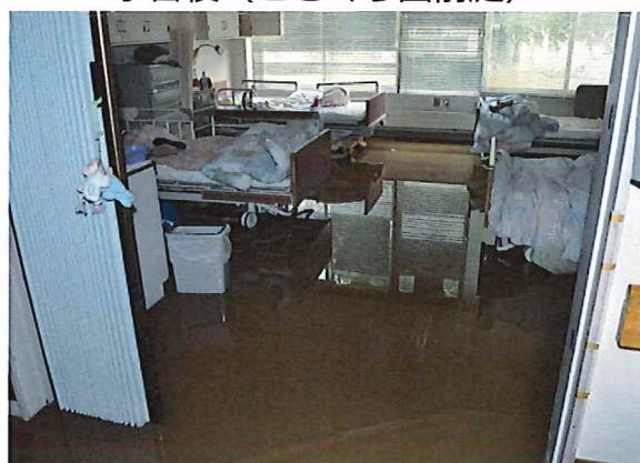
水害後（一味園居室）
